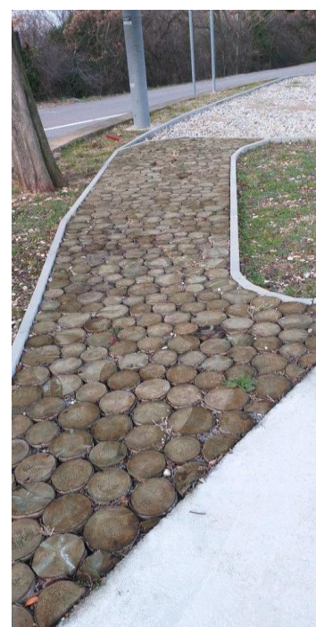
Slika 5. Mjestimično oštećena staza (propale drvene oblice)
